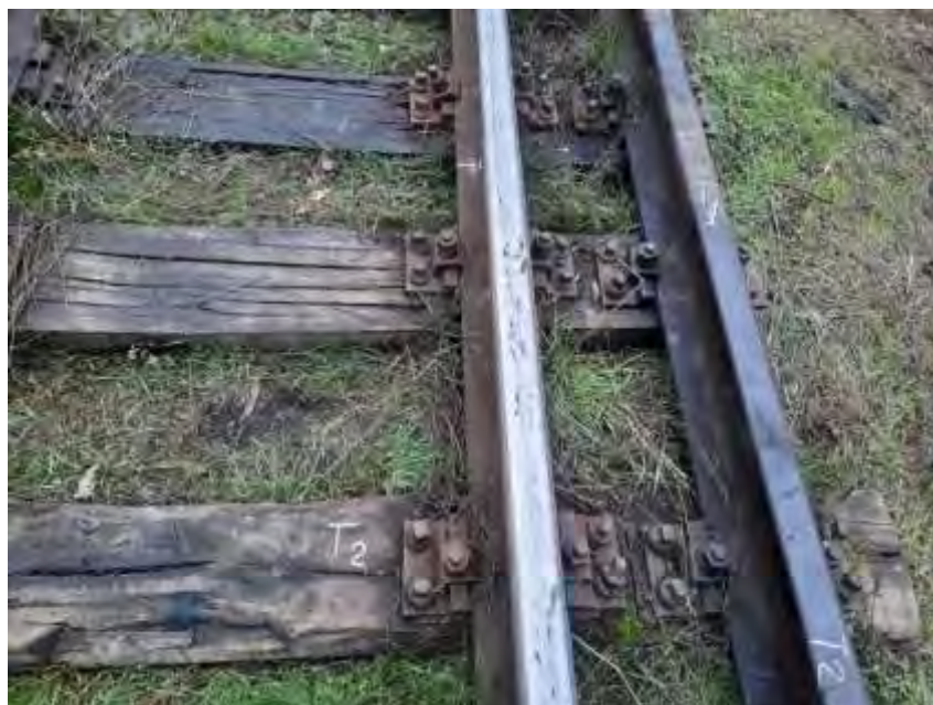
Foto nr.7 - Starea traverselor in zona punctului „0”
