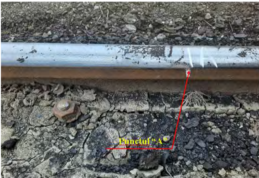
Foto nr.4, punctul „A”: urmă de cădere de pe suprafața de rulare a șinei în interiorul căii
