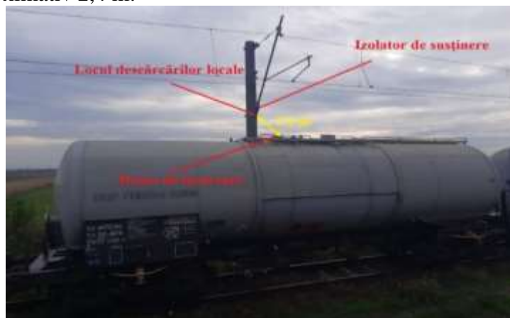
Foto nr. 14 – locul descărcărilor locale, izolator de susținere, distanța de la doma de încărcare a vagonului la izolatorii de susținere a instalației aeriene a LC, doma de încărcare;
