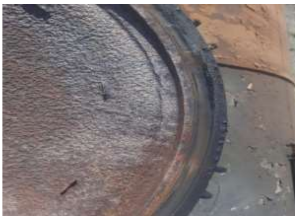
Foto nr. 5 - afectare termică la garnitura capacului domei, în partea dreaptă a sensului de mers
