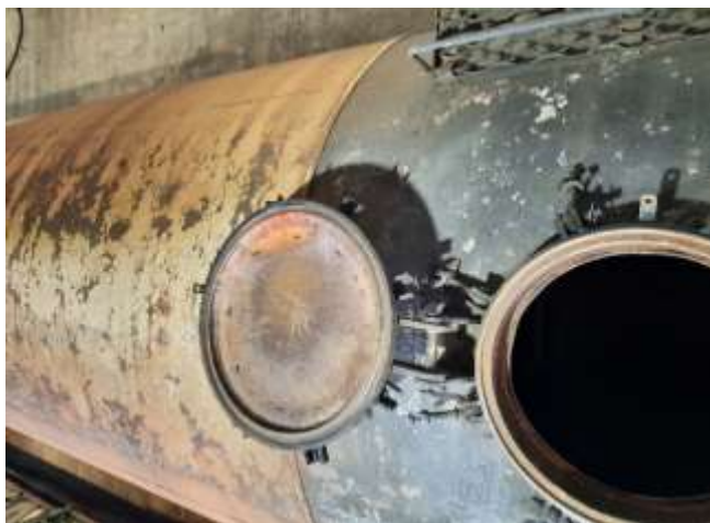
Foto nr. 8 – uşoare urme de afectare termică la partea exterioară pe partea dreaptă
