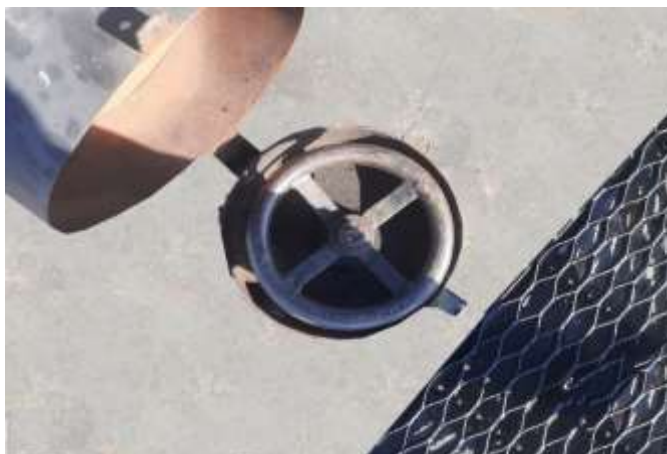
Foto nr. 3 - sistemul de acționare a ventililului central situat la partea superioară a recipientului fără urme de afectare termică
