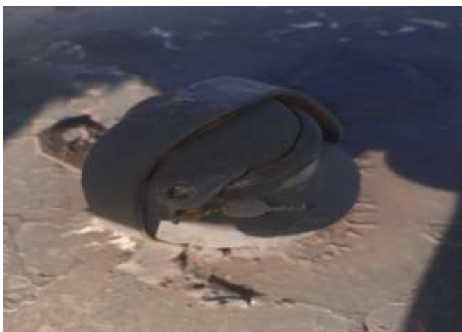
Foto nr. 2 - zona supapei de siguranță fără urme de afectare termică
