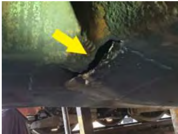
Imaginea nr.6 – sudură fisurată aflată la partea inferioară a rezervorului
