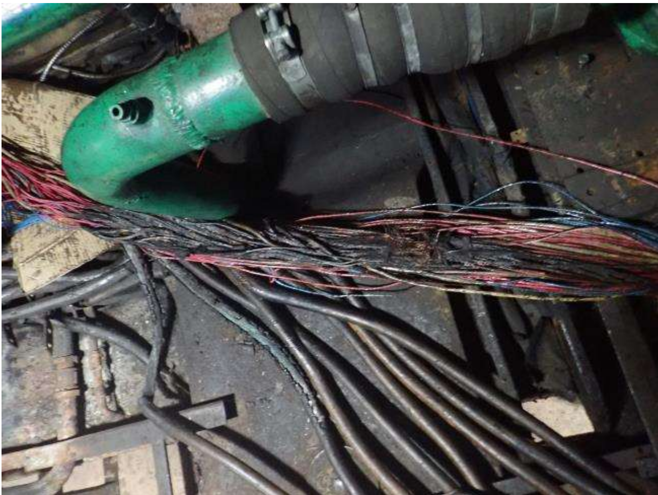
Foto nr.2 – Cablajul extras din canalul de cabluri
