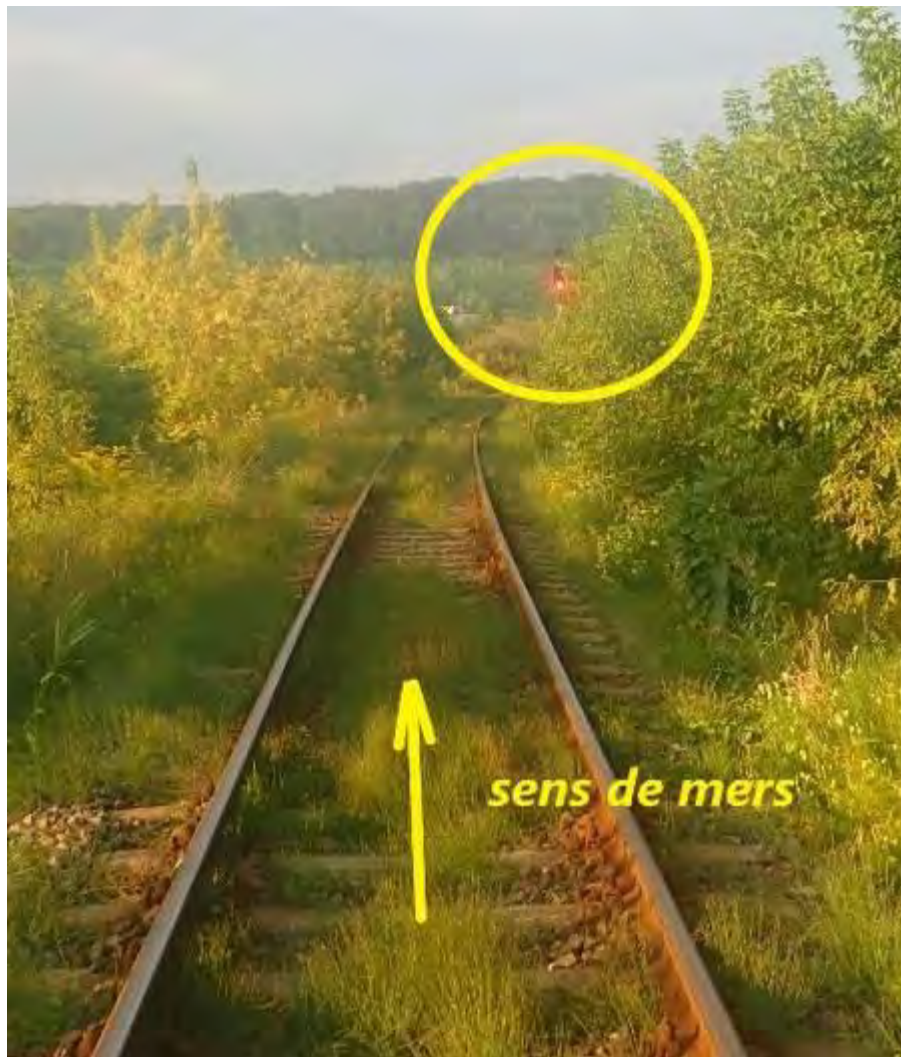
Foto nr.1 – vizibilitatea semnalului măsurată la o distanță de 73 m
