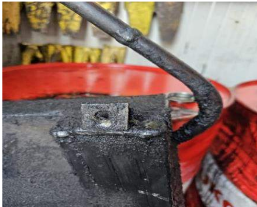
Foto nr.4 : Prinderea de jos a rezervorului și conducta de trecere dintre rezervoare
