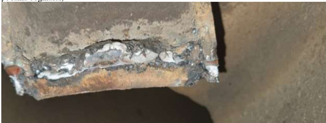
Foto nr. 11 Ruptura în suportul de fixare a amortizorului vertical
