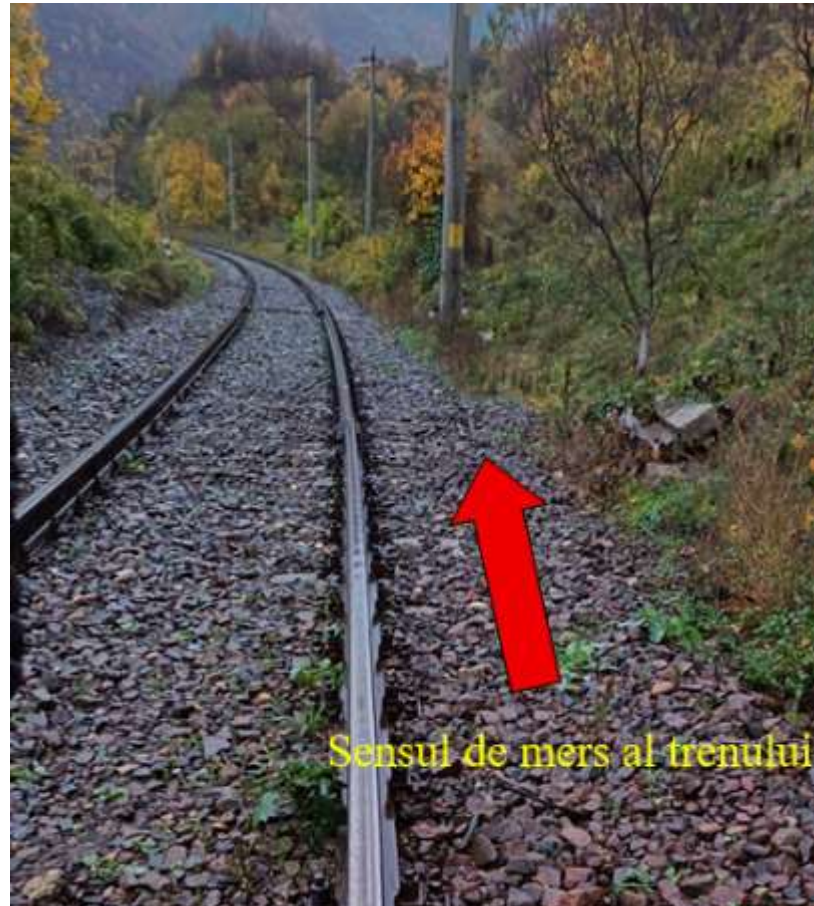
Foto nr.1 – Zona producerii incidentului
