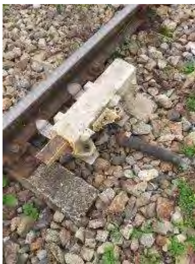
Imaginea 2 – Inductor de cale avariata
