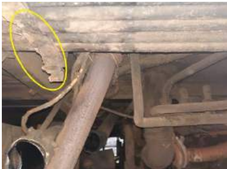
Foto nr.4. Brida de prindere stânga pe care a fost sudat radiatorul
