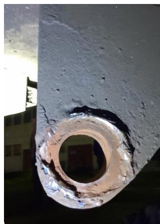
Imaginea 6 – sudura de fixare a bulonului era ruptă, cu ruptură parțial veche .
