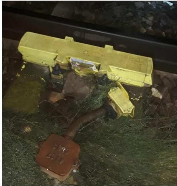
Imaginea 3- Avarie la inductorul de autostop din cale de 1000/2000 Hz aferent semnalului XR de pe BLA Călărași Turda – Câmpia Turzii. Cutia cu borne este smulsă din corpul inductorului.
