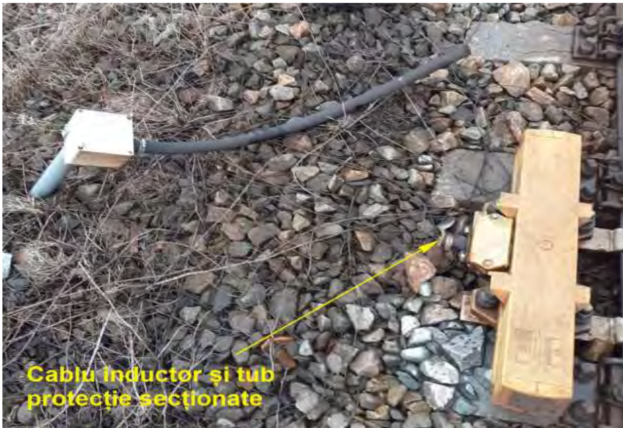
Foto nr.4 – Inductor scos din funcție prin întreruperea legăturii electrice fără a fi deteriorată carcasa sau echipamentul interior
