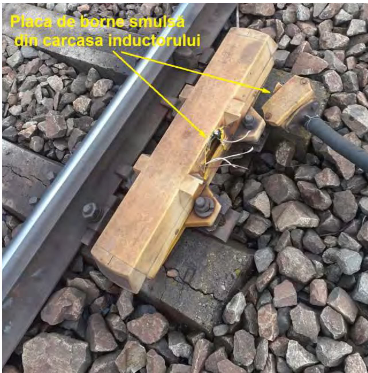
Foto nr.3 – Inductor cu placa de borne smulsă din carcasă și legături electrice întrerupte
