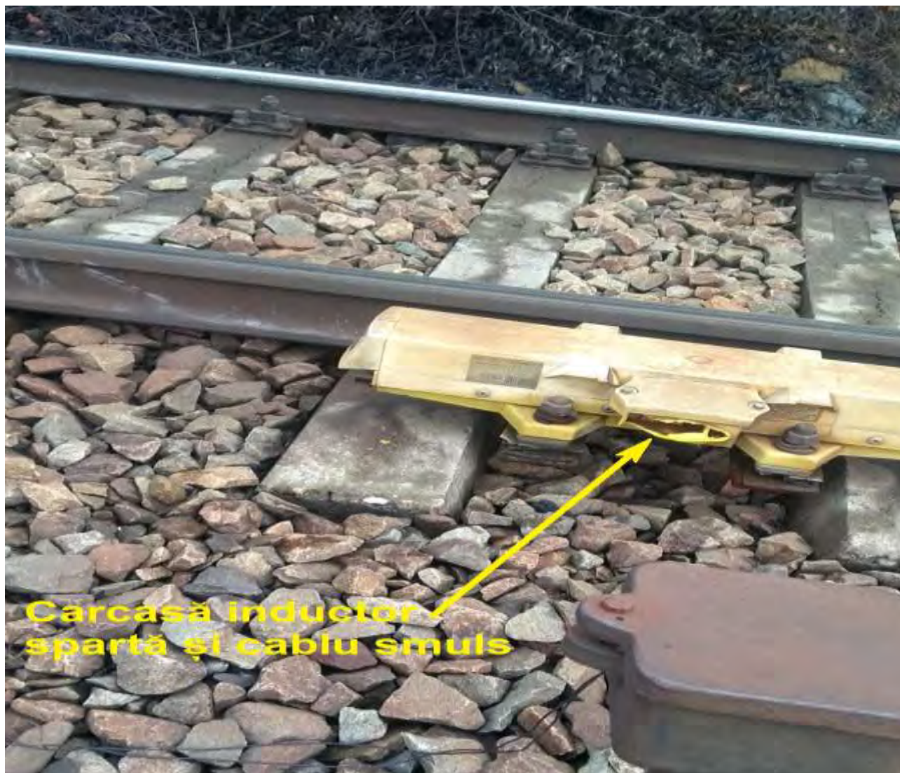
Foto nr.2 – Inductor cu cablu smuls și carcasă spartă în zona plăcii de borne
