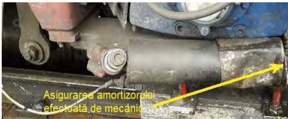
Foto nr.1 – Poziționarea și asigurarea amortizorului în stația CFR Ilva Mică
