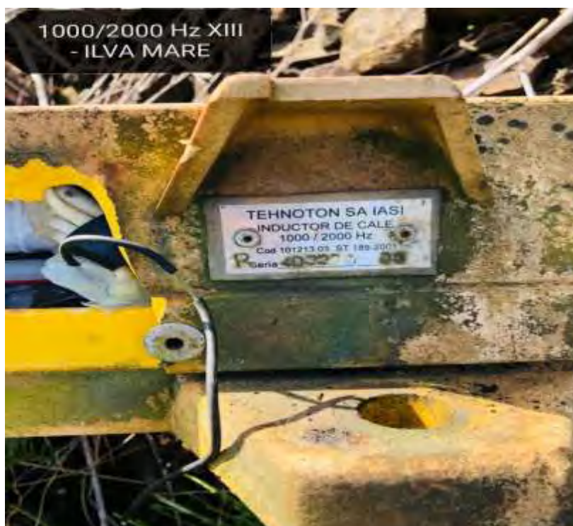
Foto nr.4 – Inductor 1000/2000 Hz cu legături electrice întrerupte și placa de borne secționată din carcasa – fabricație Tehnoton SA
