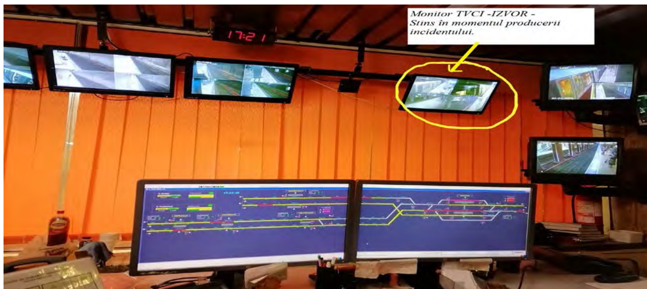
Foto nr.4 – Biroul IDM stația Eroilor
