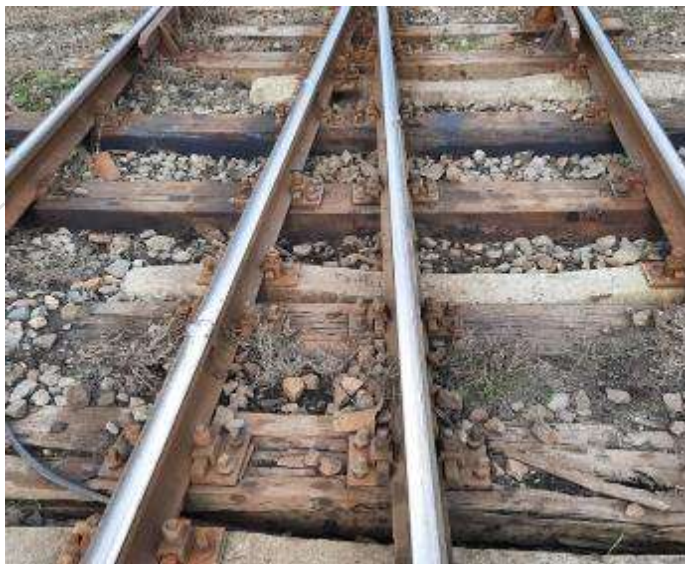
Imaginea nr.13 - zona șinelor de legătură și a inimii de încrucișare a schimbătorului de cale nr.47, la data de 21.02.2024
