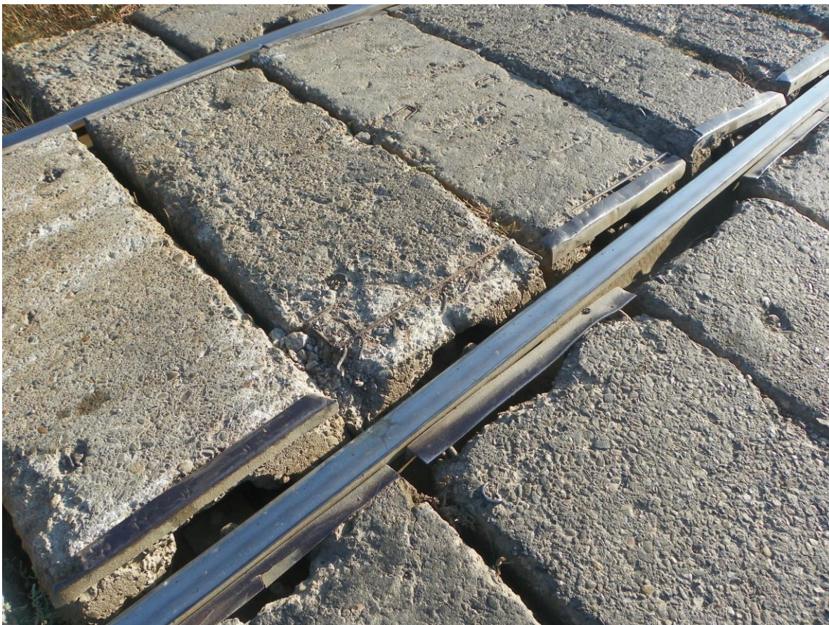
Foto.2 – starea dalelor în trecerea la nivel
